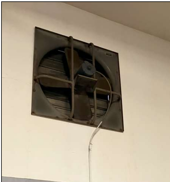
Existing exhaust fan assembly
